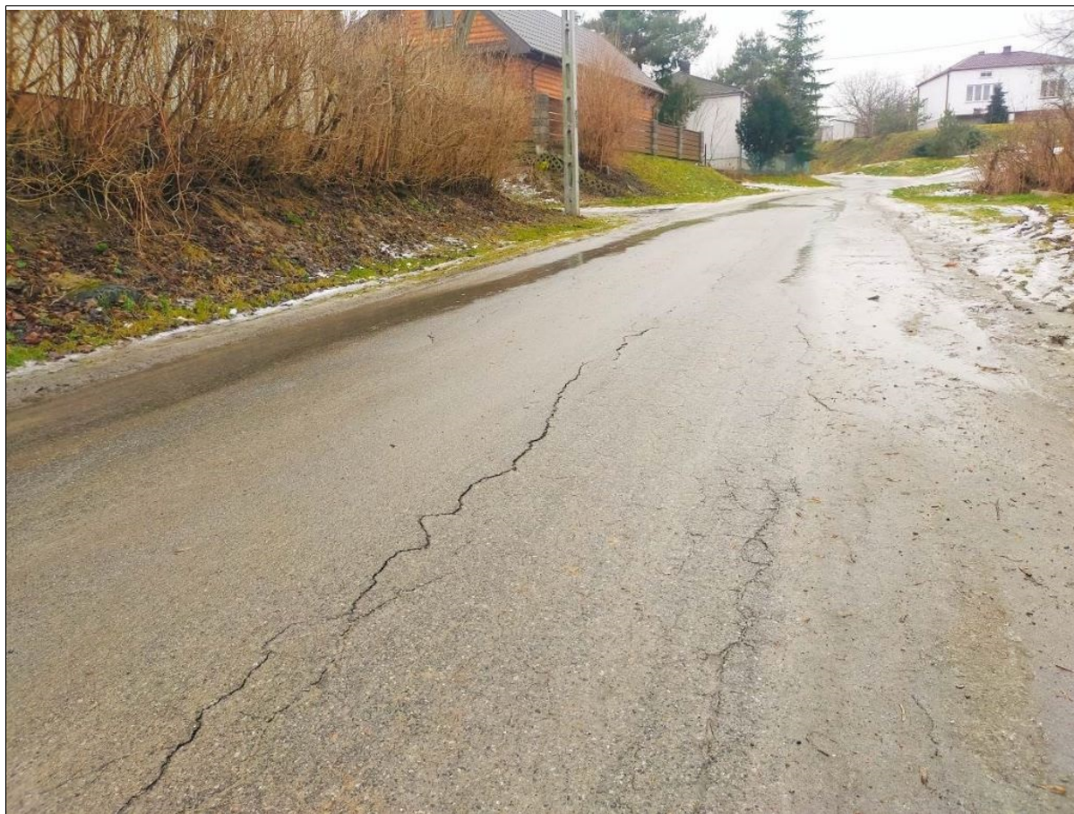
zagrożony odcinek jezdni (Nepelski 2022)
