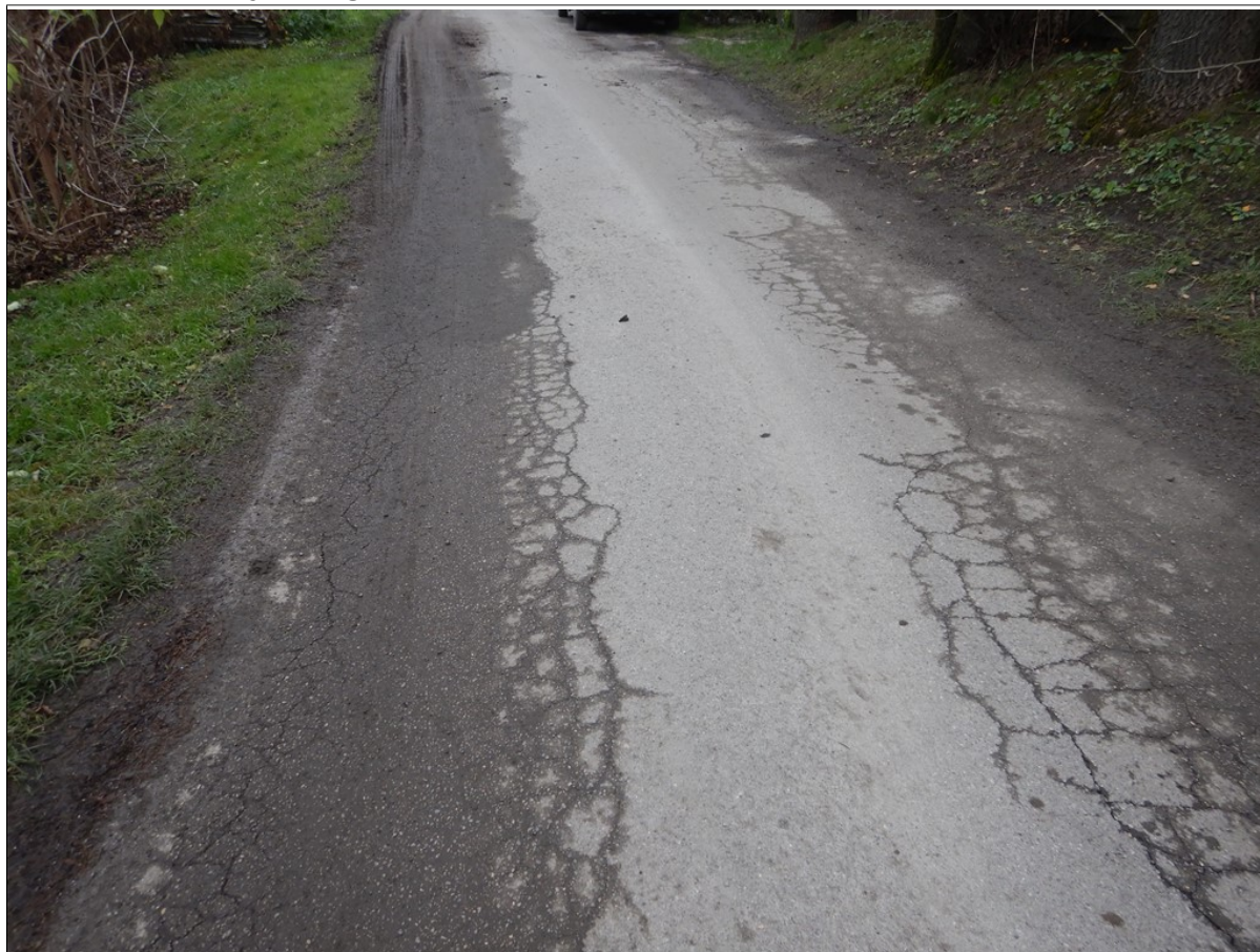
zagrożony odcinek drogi gminnej (2022)
