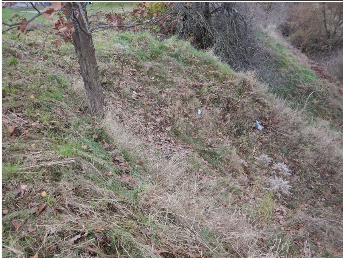
Skarpa główna osuwiska (2022)
